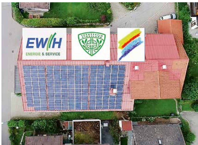
Die Solaranlage auf dem Dach der Vereinsturnhalle.
