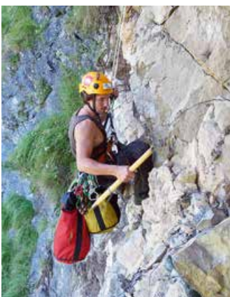
Felsberäumung am Vaterlandsweg.
