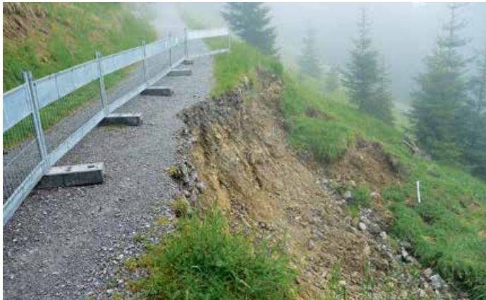
Unwetterschäden am Winterwanderweg, Imberger Horn. Bilder: MBH
