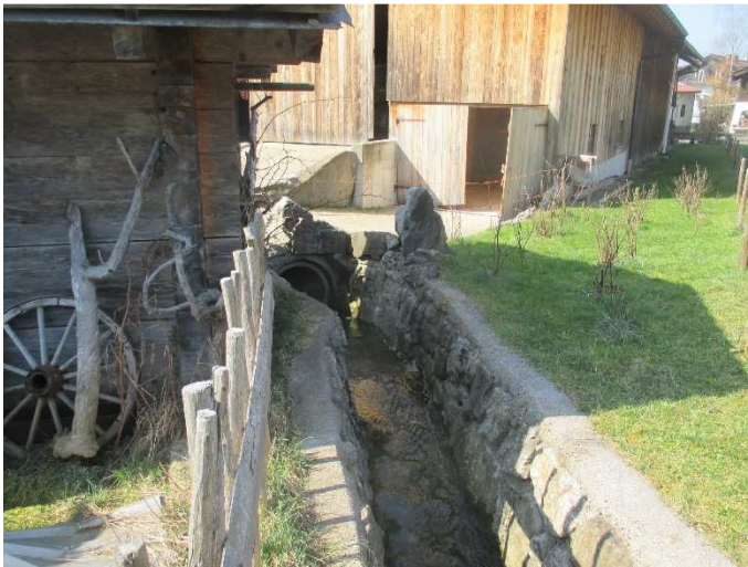
Bild 7: Einlauf in die erste Ver- rohrung DN1000. Einlauf hydraulisch ungünstig nach einer Krümmung.
